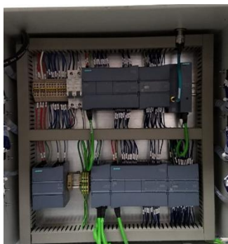
PLCs conectados en red
